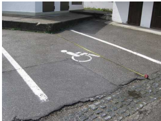
Öffentlicher Behinderten-Parkplatz in der Nähe.
