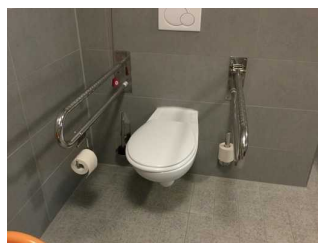
Ebene Vitaltherme: Tür zum Duschaum/ öffentliches WC (zugleich Umkleidekabine)
